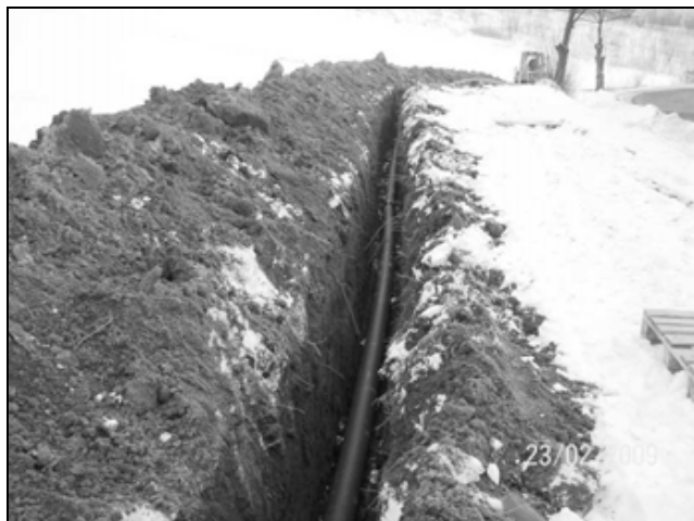
Kolektor przesyłowy DN 200 z uzdatnielni w Zarzeczcu do Żurawiczek
