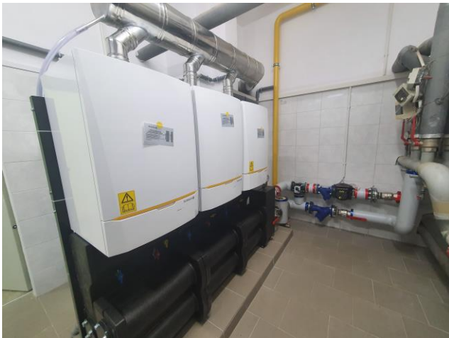
Nowa kotłownia w ZS im. W. Witosa w Zarzeczcu
